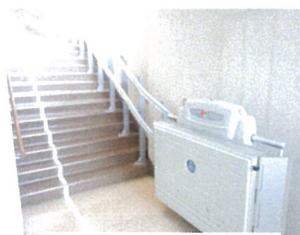
西館階段昇降機
